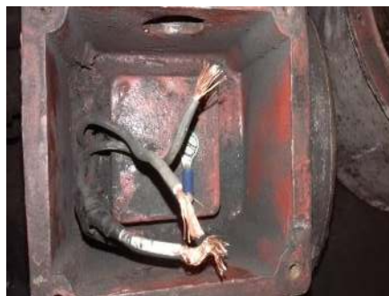
Dentro da caixa de ligação com vedação por silicone danificada e falta placa borne de ligação M5.
